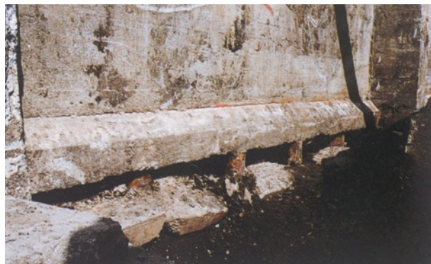
床版下の空洞と基礎コンの剥落
