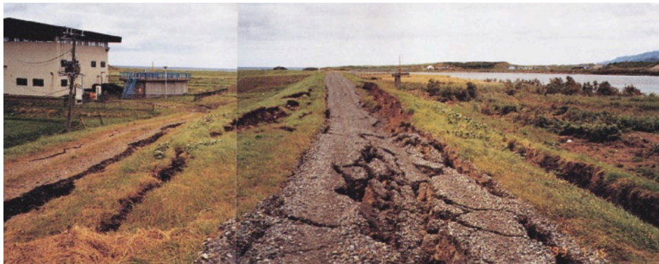
写真 2.3.7-1 後志利別川堤防の災害状況
