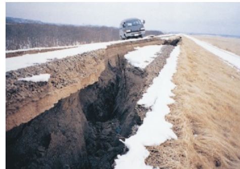
▲遊水地左岸築堤 KP 11.7 付近 上流側より下流側を望む。堤内側小段より堤外側のり尻にかけて沈下陥没を伴う堤外側のり面の崩壊が生じ、堤体形状が保たれていない。堤外側のり尻が張出している。（被災区間番号：釧路川-⑨）
