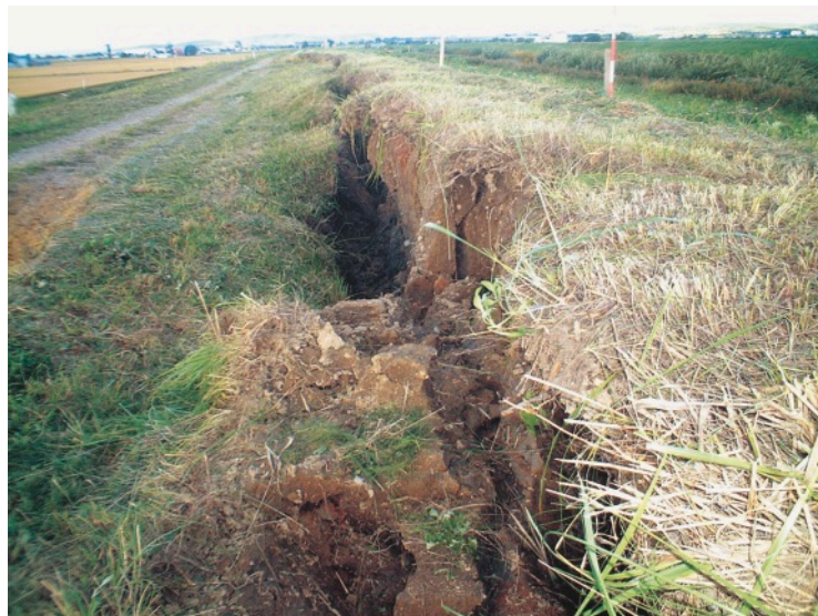
写真 2.3.9-1 清真布川左岸堤防の液状化に伴う沈下とクラック
