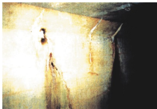
発錆クラックから浸み出ている漏水 と水が流れている状態
