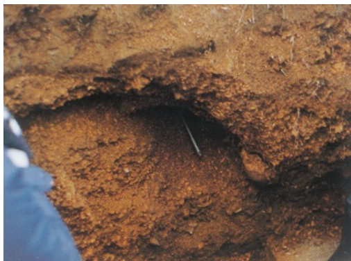
躯体上部隅角部より発達したアーチ型空洞
