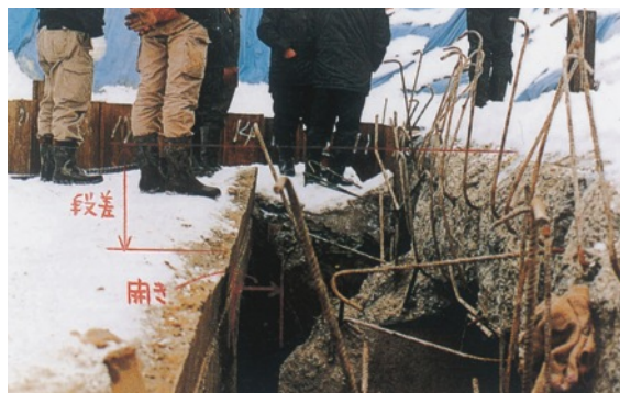
不同沈下による躯体継手部の開口と段差 (継手カラー撤去後)
