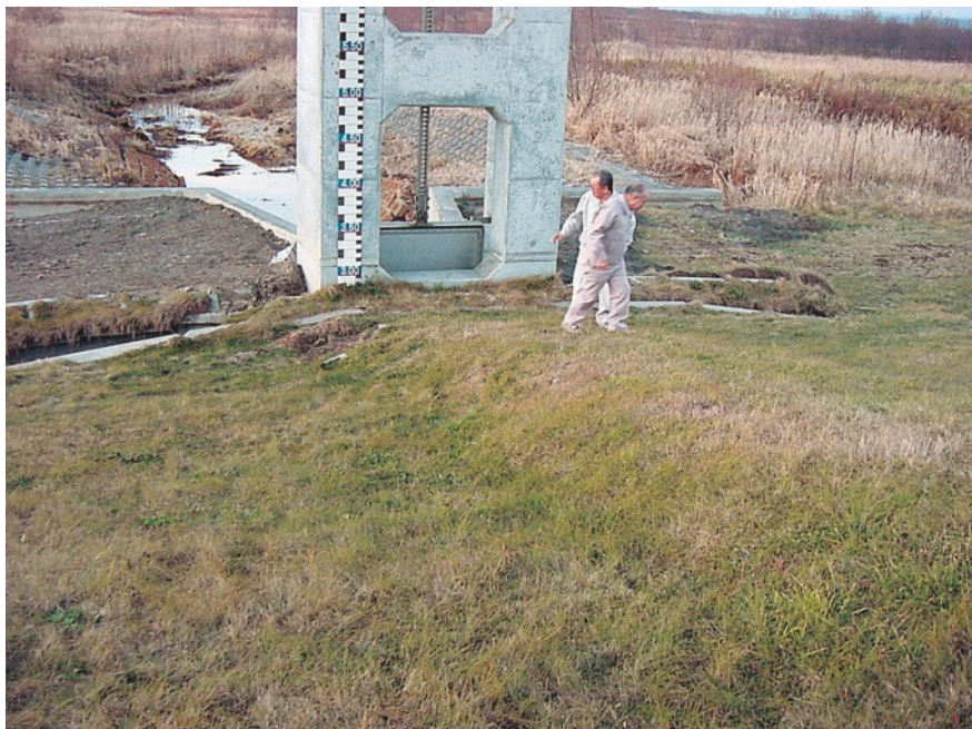
写真 2.3.9-3 十勝川右岸堤防、柔構造樋門の抜け上がり等の損傷 (抜け上がり高 0.6~0.8 m)
