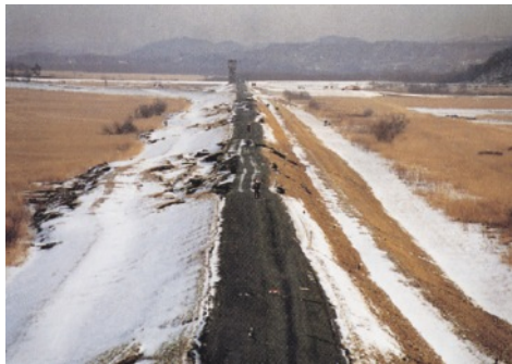
▲遊水地左岸築堤 KP 9,260～9,500 間 下流側より上流側を望む。のり肩からのり面にかけて沈下・陥没を伴う堤外側のり面の崩壊が生じ、元の堤体形状を保っていない。堤体内盛土が堤外側のり尻を突き破り流出している。（被災区間番号：釧路川-⑧）
