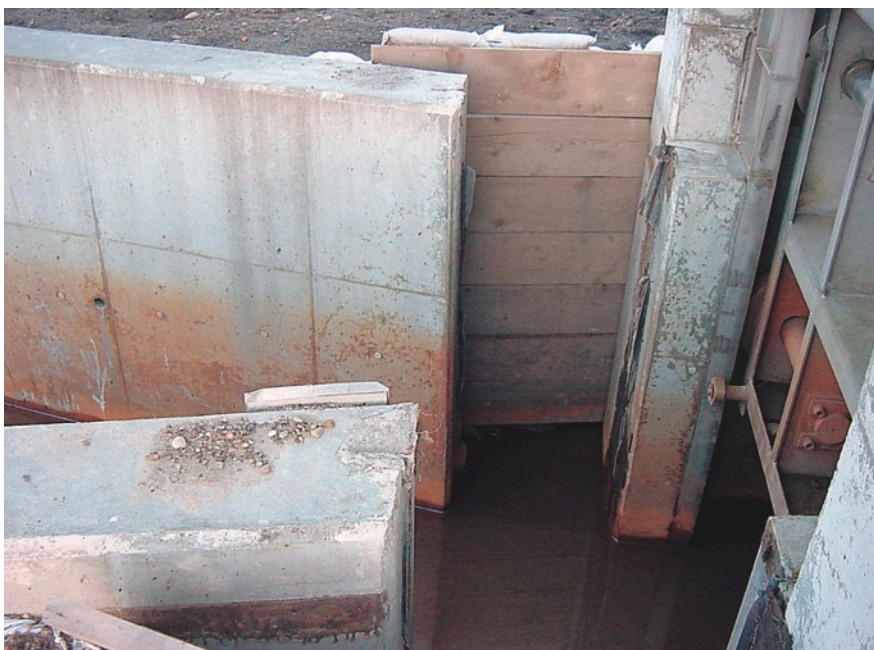
写真 3.3.9-4 十勝川右岸堤防、柔構造樋門翼壁の離脱移動（約 0.8 m）
