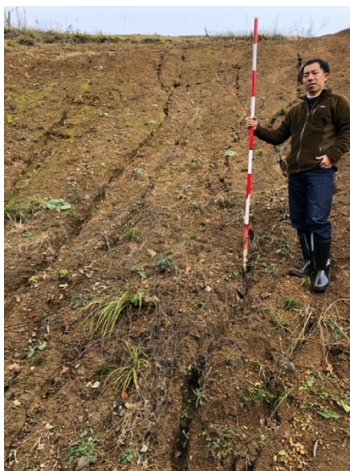
図3-9 土砂崩壊面のガリ侵食
