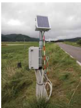
(a) 太陽光パネル設置後のデータロガー全容
