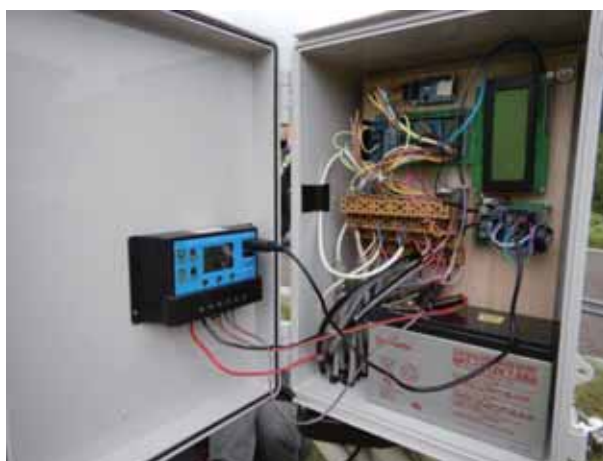
(b) データロガー内部の更新の様子
