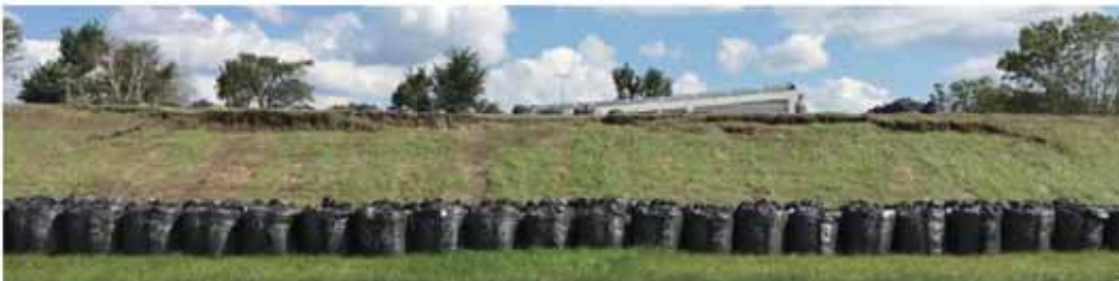
図30 堤防法面すべり(平成28年8月)
