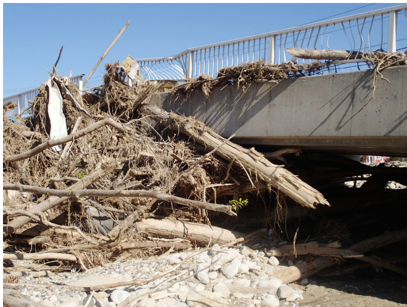
図3 橋梁による流木の三次元的堆積（ペケレベツ川，2016年北海道豪雨災害）
