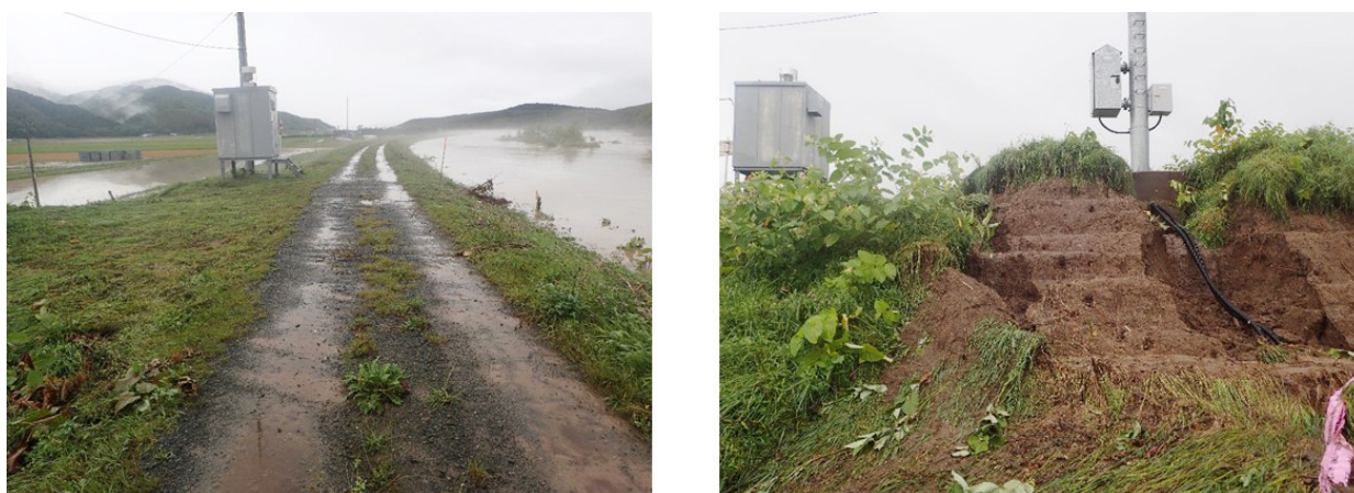
図2 越水侵食箇所 (左：上流側から撮影した全景，右：裏のり尻から撮影した侵食箇所)
