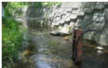
(a) 水位計設置状況
