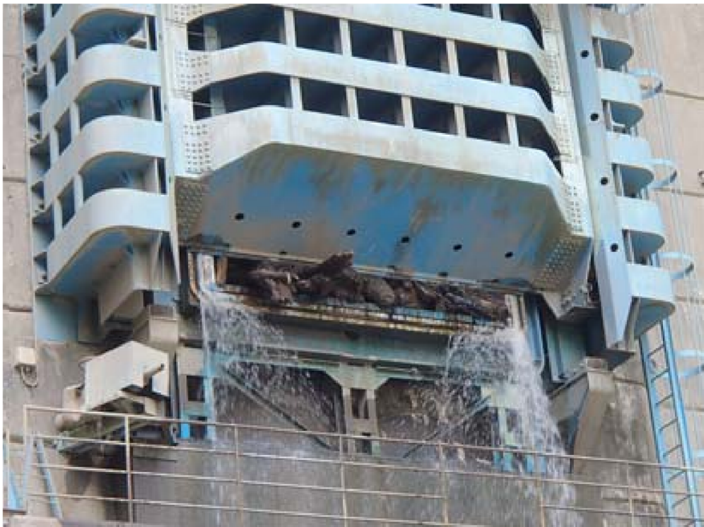
図1 裾花ダムのゲート付近に堆積した流木の様子（2017） 1)
