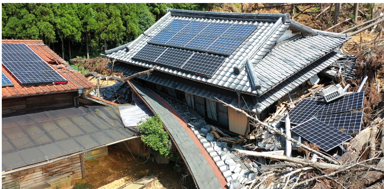
図1 2020年7月の豪雨によって被災した熊本県芦北町田川地区の家屋
