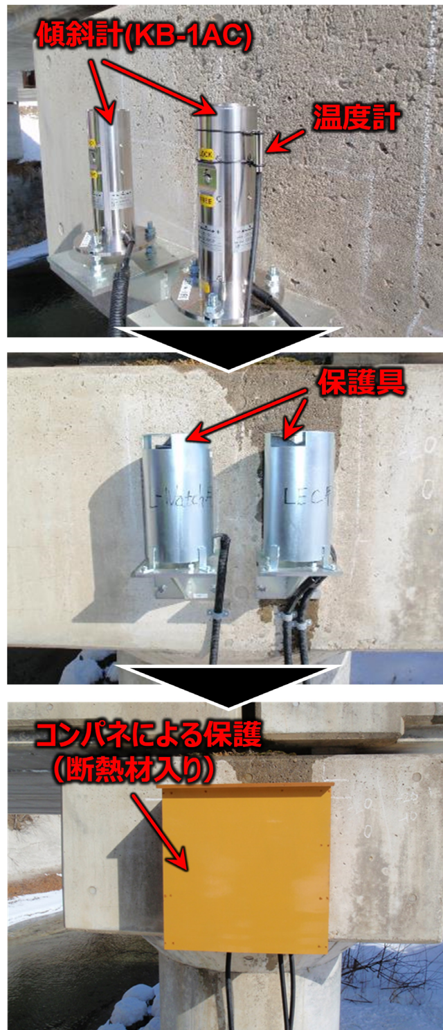
図-16 傾斜計の設置状況
